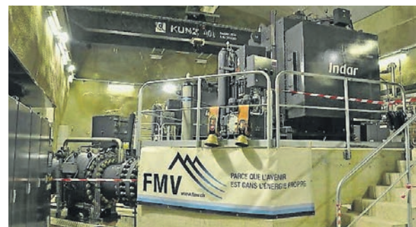
Das neue Wasserkraftwerk im Goms. Foto Energieregiongoms
